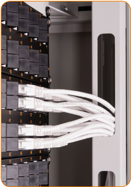
Непосредственный вывод шнуров на вертикальный органайзер при использовании патч-панелей NIKOMAX с угловыми портами
